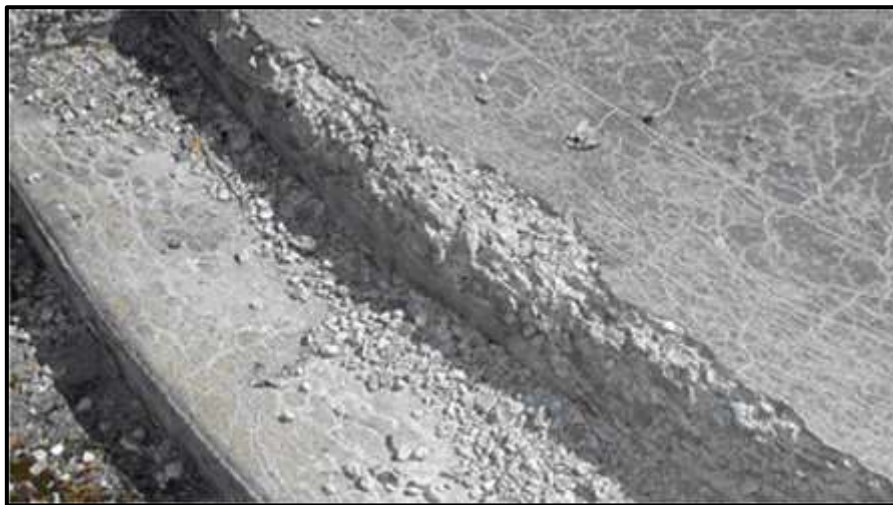
Figure IV.1 : Aspect visuel typique d'un élément de béton sévèrement endommagé par la fissuration due à l'action des cycles de gel-dégel [15]
